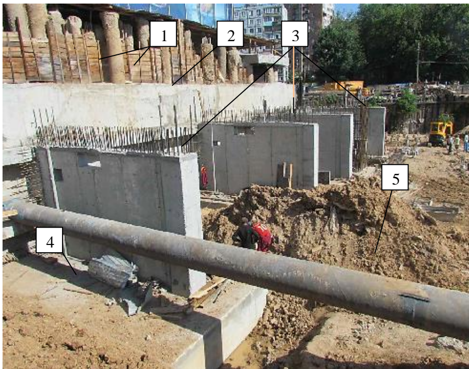
Рисунок 3. Фрагменты выполненных монолитных железобетонных контрфорсов: 1 – существующие буронаблюдательные сваи ограждения котлована; 2 – ограждение котлована из монолитного железобетона; 3 – монолитные железобетонные контрфорсы усиления существующей подпорной стены; 4 – монолитный железобетонный ростверк; 5 – существующая труба – расстрел усиления
